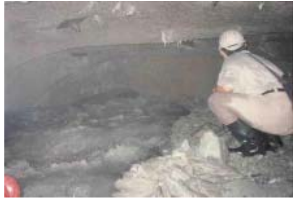
圖 3 隧道坍塌湧水圖(1998.10.30)
